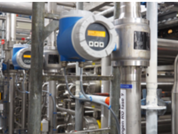
Peripheriegeräte wie z. B. Sensoren wurden von renommierten Herstellern wie Endress + Hauser geliefert (Foto: mi)
