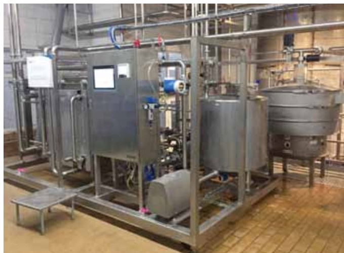
Gesamtansicht der vormontierten Anlage (Quelle: GEA)
