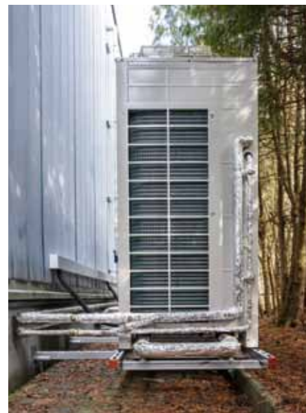
Insgesamt zwei ZEAS von DAIKIN mit einer Gesamt-Kühlleistung von 60 kW wurden im Außenbereich des Betriebs installiert (Foto: DAIKIN)
