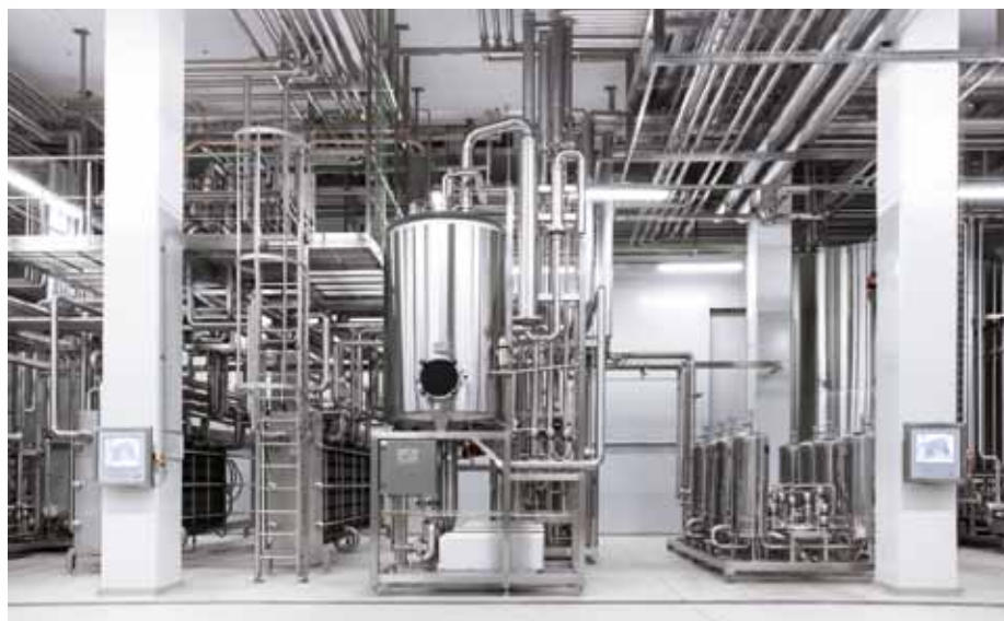
Entgaser in einer Anlage für die Produktion von Säften (Foto: Ruland)
