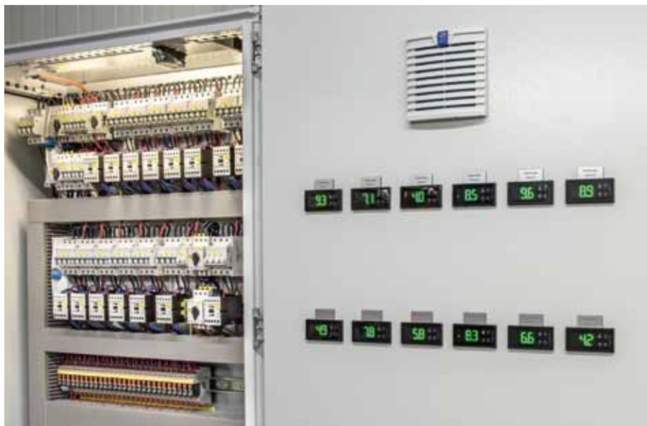
Die Steuerung ist das Herzstück der Lagerhalle. Sie sorgt für die ideale Temperatur der Räume, abgestimmt auf die jeweilige Käsesorte (Foto: DAIKIN)
