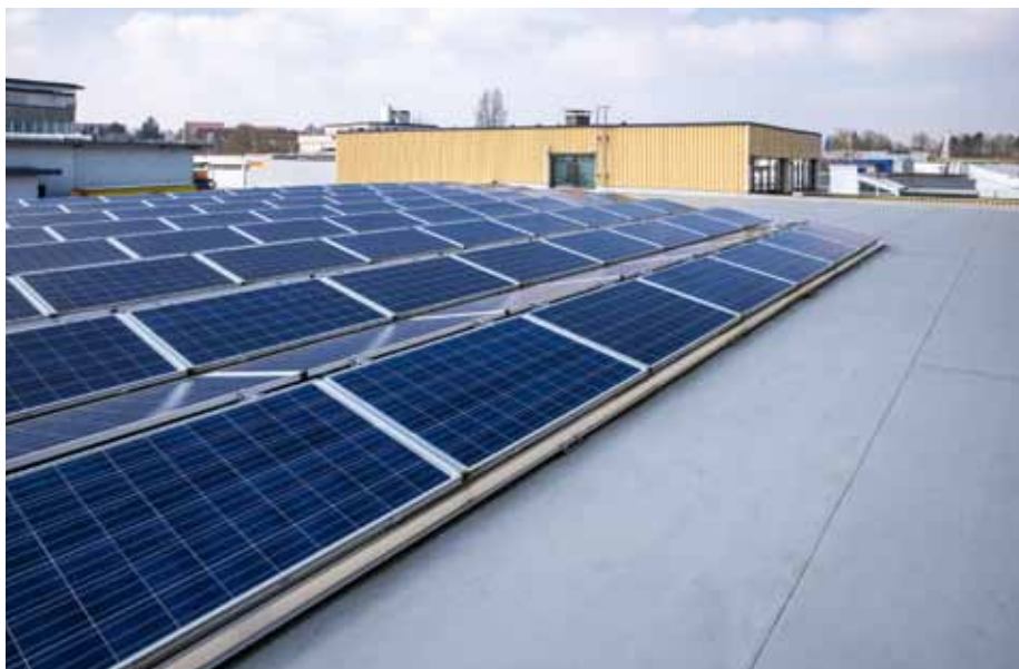
Eine 40 kWp Photovoltaikanlage versorgt die ZEAS mit Strom. Das Besondere: Überschüssige Energie wird in Form von Kälte gespeichert (Foto: DAIKIN)
