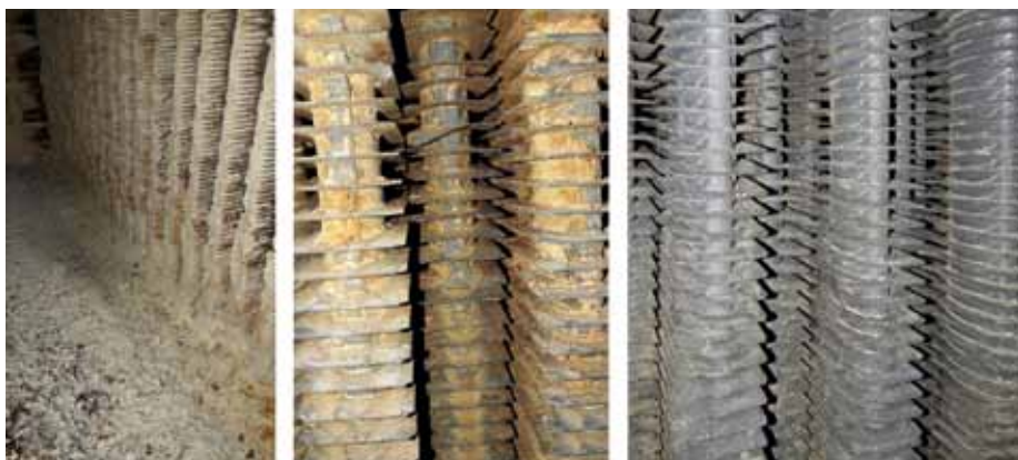
Lamellenwärmetauscher vor und nach der Reinigung (Foto: Kipp Umwelttechnik)
