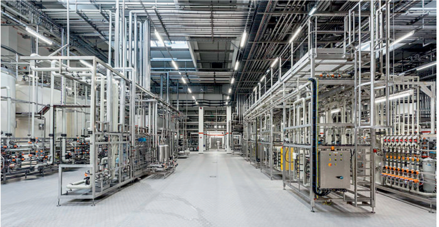
Der Blick in die Molkenverarbeitung lässt ahnen, welch hochkomplexe Prozesse Hochwald in Hünfeld fährt (Foto: Hochwald)
