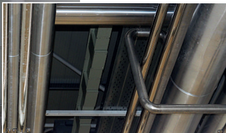
Die Stromübertragung erfolgt für mehr Brandschutz entlang der Werksachse über einen sog. „Busduct“ (Foto: mi)
