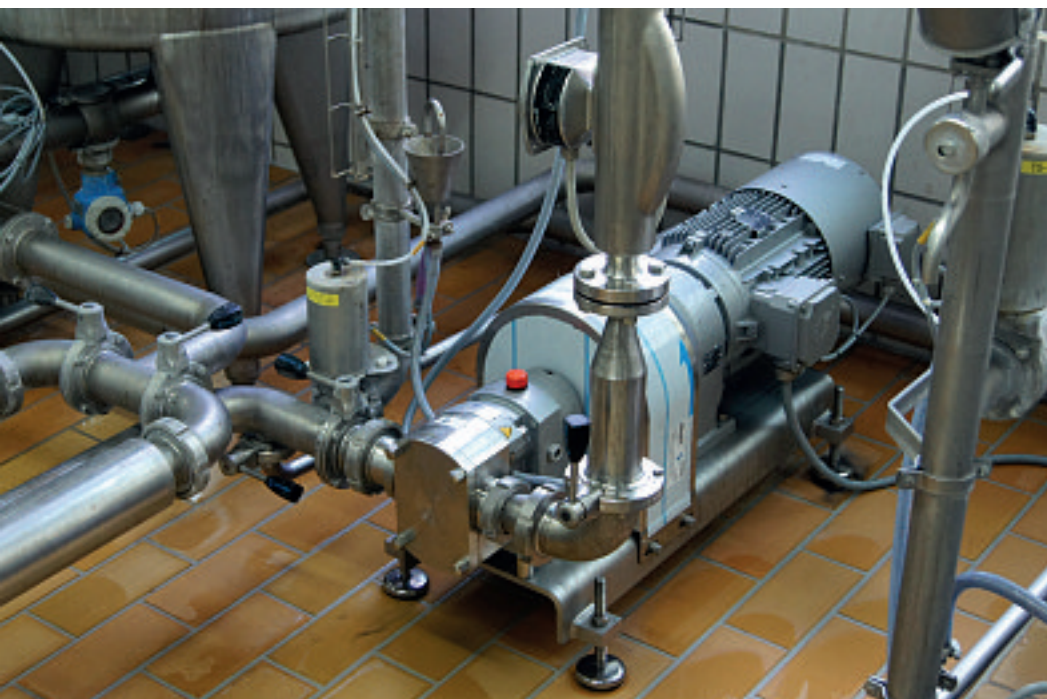
FL3 Drehkolbenpumpen werden bei Uelzena zur Konzentratförderung auf den Sprühturm eingesetzt
