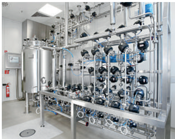
Anspruchsvolle Lösung für eine Membranfiltration in einem Reinraum (Foto: Ruland)
