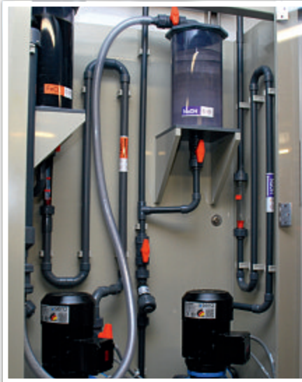
Hier werden NaOH und 'Ferrifloc' in das Abwasser dosiert (Foto: mi)
