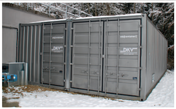
Die Flotationsanlage ist in zwei 40' Schiffscontainer eingebaut (Foto: mi)
