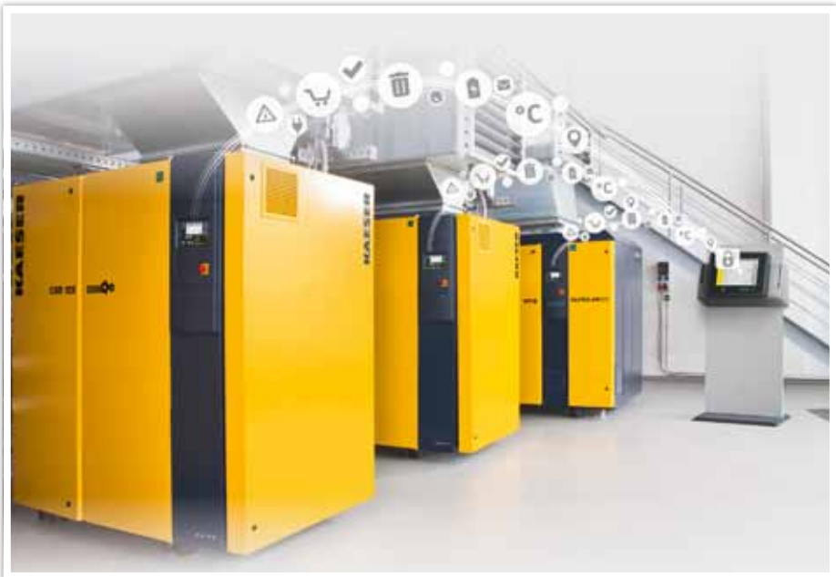
In der Station selbst kommunizieren die einzelnen Komponenten zur Druckluftherzeugung mit der übergeordneten Steuerung
