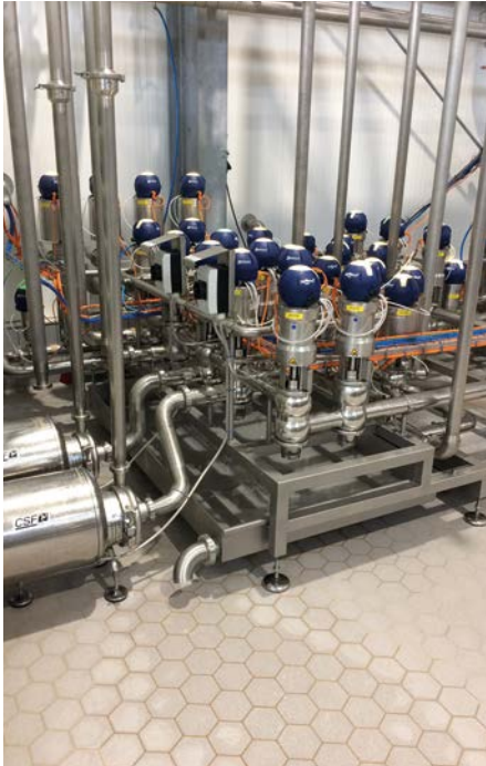
Bardiani-Ventile und CSF-Pumpen stellen den Rohstoffdurchfluss sicher
