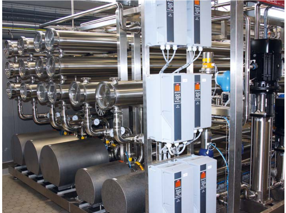
Blick auf die UO-Anlage im Werk Kranenburg
