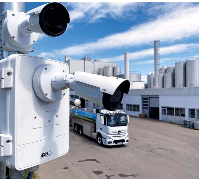
Der Außenbereich bei den Milchwerken Schwaben wird von einer AXIS P1447-LE und einer AXIS P3719-PLE Multisensor-kamera überwacht (Foto: AXIS)
