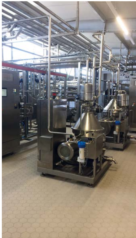
REDA hat die Käserei mit einem Molkenpasteur und Separatoren ausgerüstet
