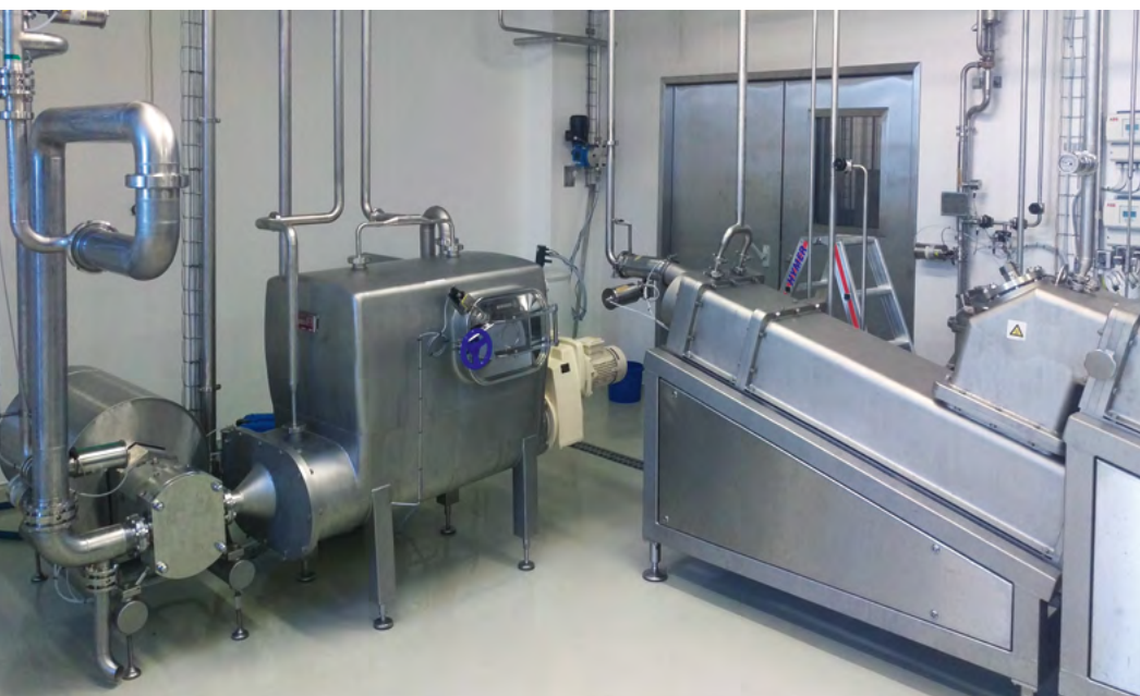
Blick auf die Butterungsanlage bei der Vorarlberg Milch
