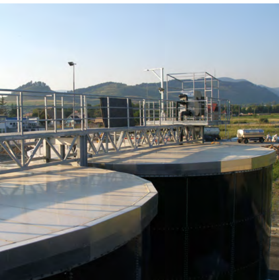
Am Hochland-Standort Prokhorovka wurde eine Biomar Abwasseranlage installiert (Foto: EnviroChemie)
