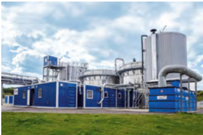
Mehrstufige biologische Abwasserbehandlungsanlage für eine Großmolkerei
