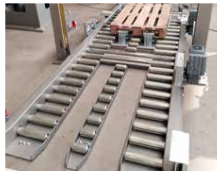
Tiefergelegte Palettenfördertechnik (Foto: gdm project UG)
