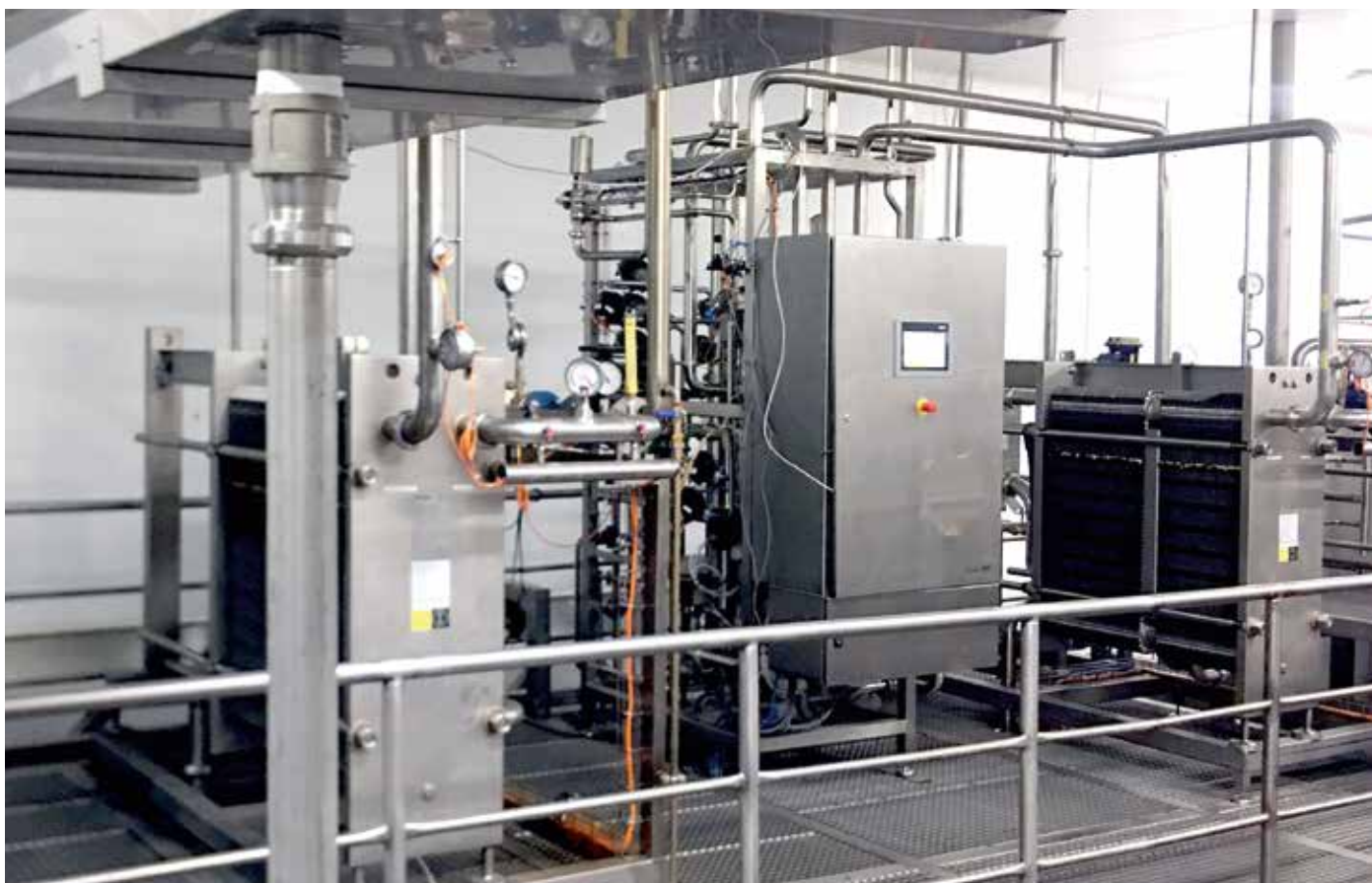
Kri Kri nutzt einen zweistufigen NL 80 2-Plattenwärmetauscher für die Bearbeitung koagulierter Milch (Foto: Kelvion)
