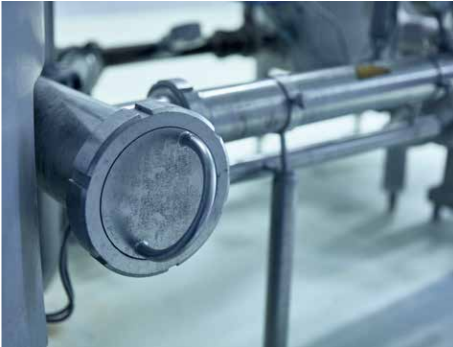
Bei Eckrohrsiebe kommt es immer wieder zu schweren Verätzungen mit Lauge oder zu Verbrühungen durch Dampf (Foto: BGN)
